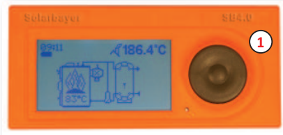
Display grafico con schema idraulico predefinito di Solarbayer. Monitoraggio della temperatura dei gas di scarico, della temperatura della caldaia e della temperatura del serbatoio.
